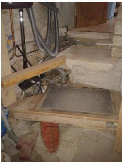
arrivée dans la chaufferie
