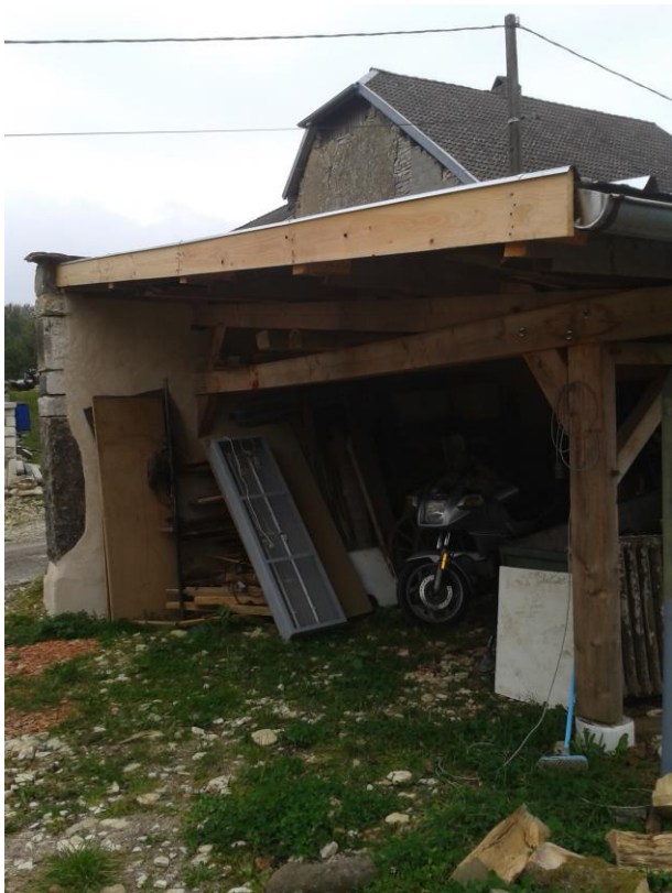
photo 1 les capteurs seront fixés sur le toit de cet abri
