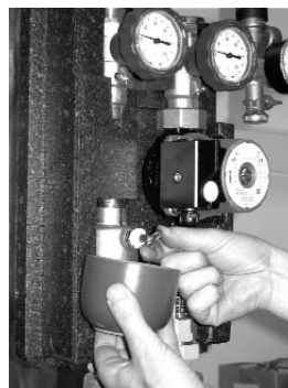
Point 7 : séparateur d'air
