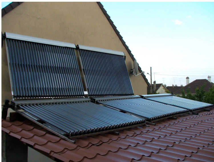
L'installation global ECS et Chauffage.
