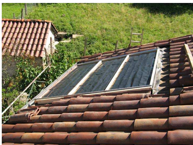
Les absorbeurs sont en place.
