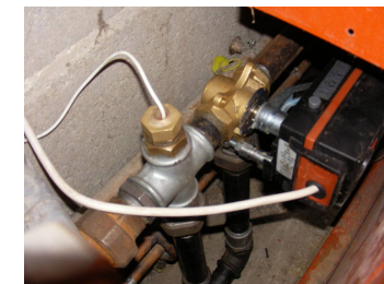
Vanne 3 voie TOR Appoint solaire sur le retour chaudière
