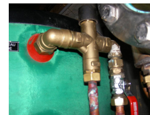
Mitigeur thermostatique à la sortie du Chauffe-eau solaire Maxi 60°
