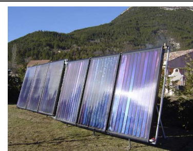
3 - Capteurs verticaux posés au sol et inclinés à 70° près d'une habitation.
