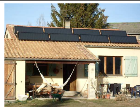
2 - Capteurs horizontaux inclinés à 60° en toiture.
