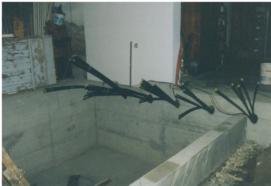
Figure 1 : sondes en double U avec en premier plan la fosse de la cuve à eau
