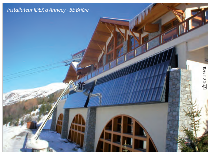
Le centre aquatique des Menuires (Savoie-73) ; capteur TGD Th de 124 m 2
